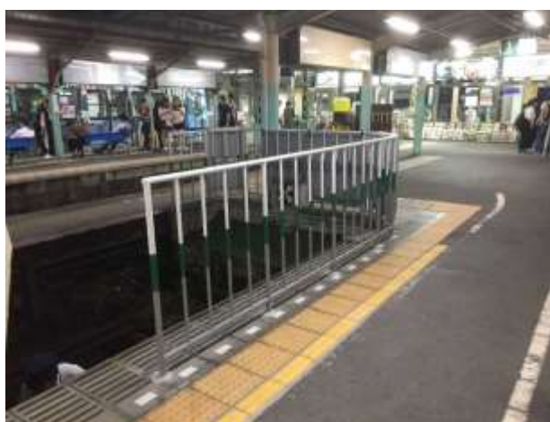
転落防止用固定柵（出町柳駅）②
