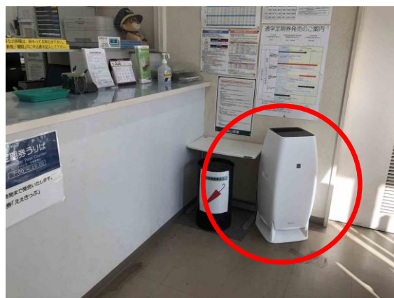
駅に空間除菌消臭装置を設置
