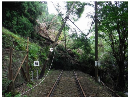
線路に覆いかぶさった土砂・倒木 (2020年7月8日撮影)
